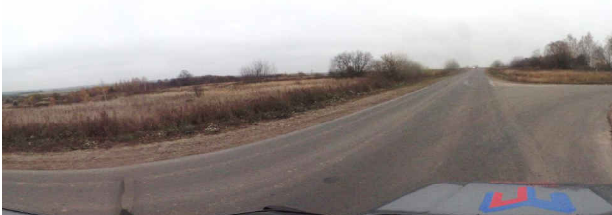
Рисунок 1.3.3 – Состояние дорожного покрытия а/д 17 ОП МЗ 17Н-73 Юрьев-Польский – Семьинское – Авдотьино – «Фетинино – Спасское» на момент обследования
