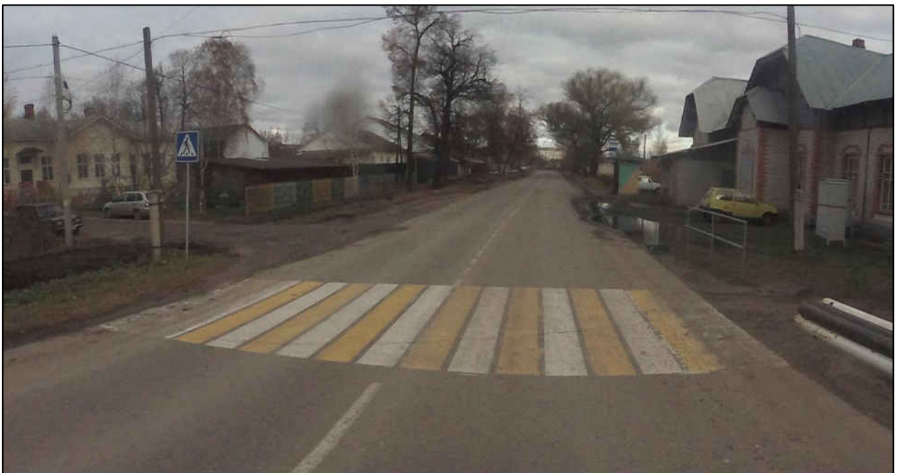
Рисунок 1.6.5 – Пример эксплуатационного состояния горизонтальной разметки 1.1, 1.7 и отсутствия разметки 1.14.1 (обозначающей пешеходный переход) нанесённых в г. Юрьев-Польский по ул. Железнодорожная
