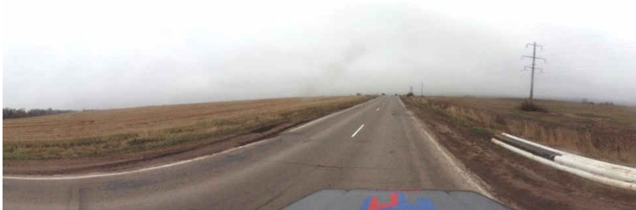
Рисунок 1.3.4 – Состояние дорожного покрытия а/д 17 ОП МЗ 17 Н - 74 Юрьев-Польский – Григорово – Гаврилов Посад – Тейково на момент обследования
