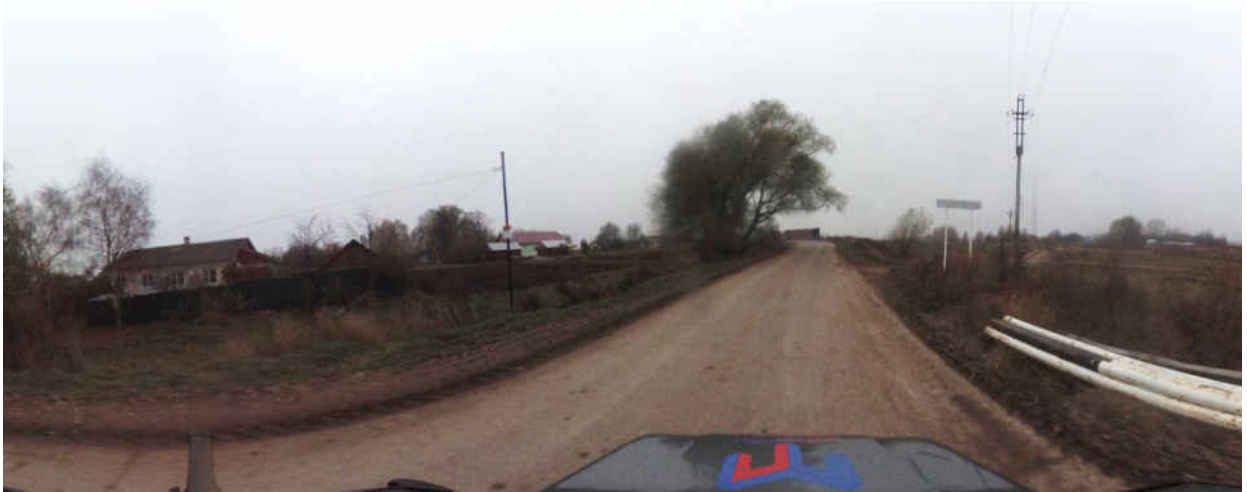
Рисунок 1.3.6 – Состояние дорожного покрытия а/д 17 ОП МЗ 17Н-737 Федоровское – Красное Заречье на момент обследования
