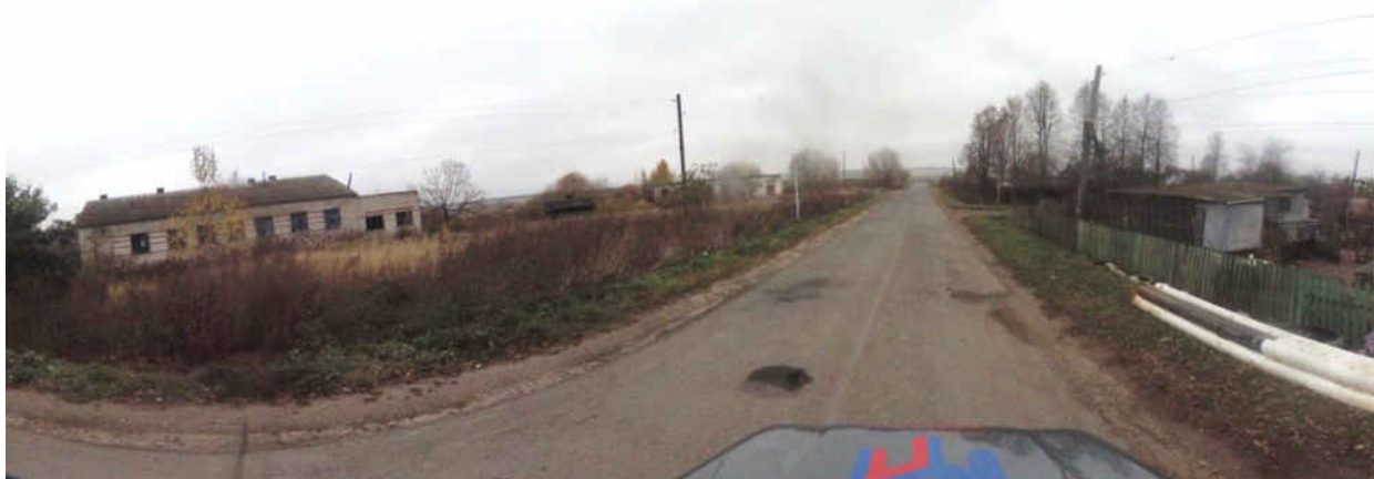
Рисунок 1.3.9 – Состояние дорожного покрытия а/д 17 ОП МЗ 17Н-757 «Юрьев-Польский – Горки» – Косинское на момент обследования
