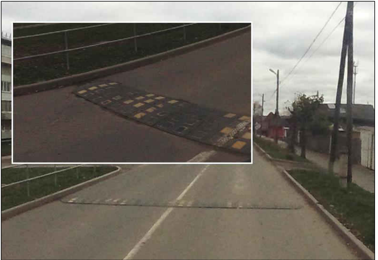
Рисунок 1.6.7 – Пример эксплуатационного состояния ИН сборно-разборной конструкции, расположенной в г. Юрьев-Польский, по ул. Школьная
