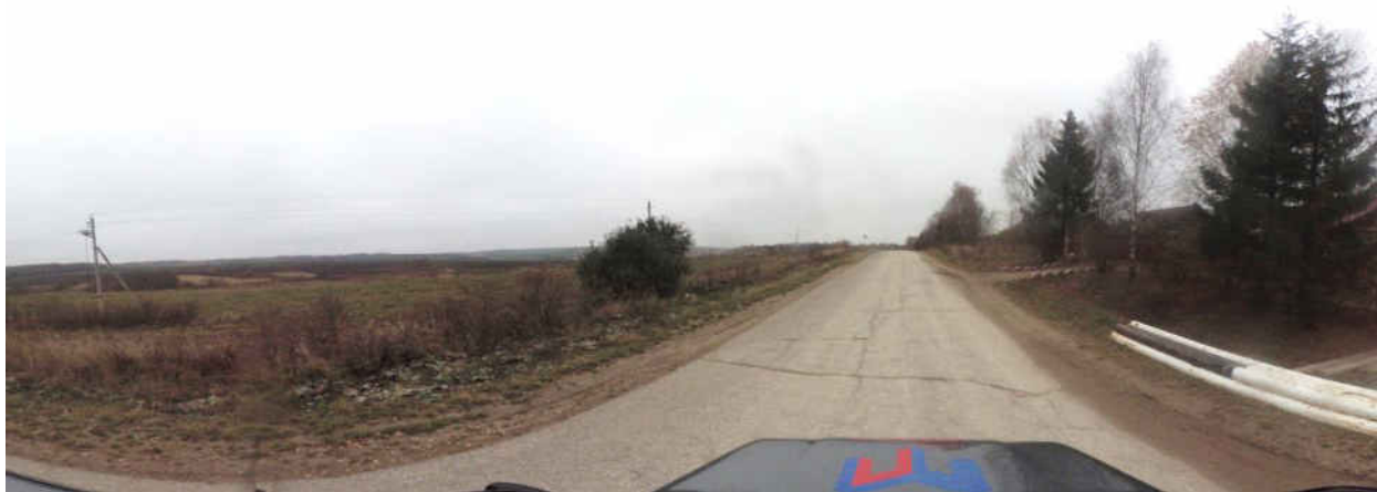
Рисунок 1.3.8 – Состояние дорожного покрытия а/д 17 ОП МЗ 17Н-756 Юрьев-Польский – Горки на момент обследования
