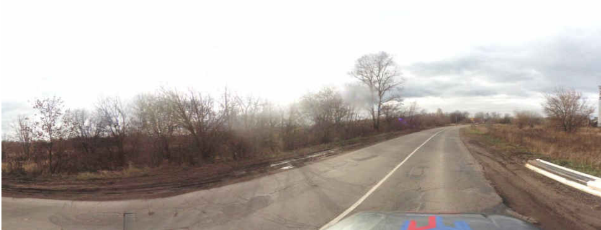
Рисунок 1.3.5 – Состояние дорожного покрытия а/д 17 ОП МЗ 17 Н - 75 «Владимир – Юрьев-Польский» – ж/д переезд на момент обследования
