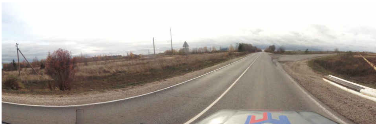
Рисунок 1.3.2 – Состояние дорожного покрытия а/д 17 ОП РЗ 17 К - 10 Юрьев-Польский – Кольчугино на момент обследования
