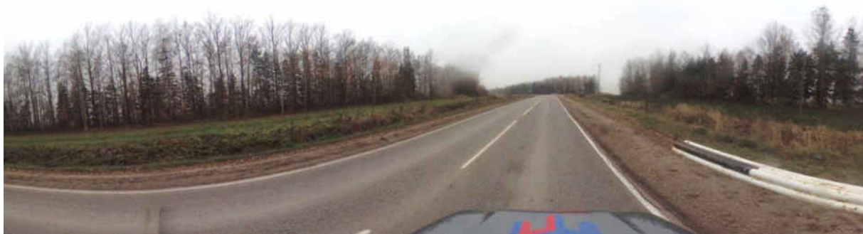
Рисунок 1.3.1 – Состояние дорожного покрытия а/д 17 ОП РЗ 17А-1 Владимир – Юрьев-Польский – Переславль-Залесский на момент обследования
