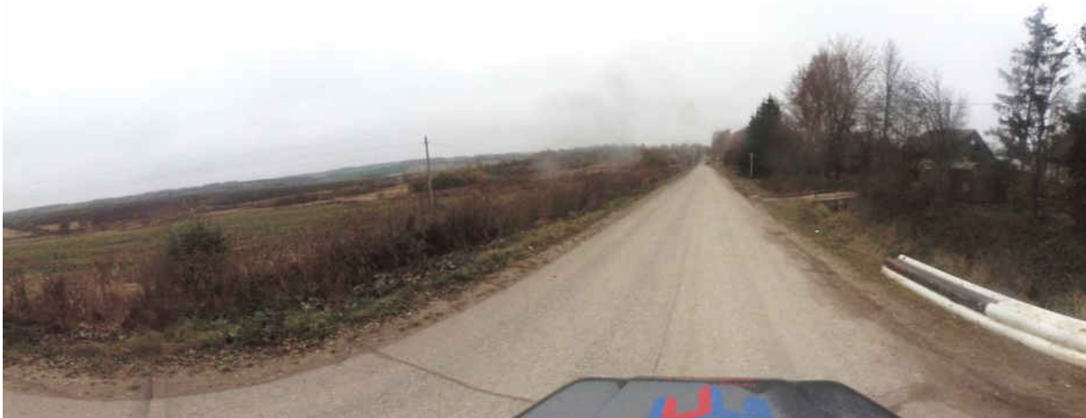
Рисунок 1.3.10 – Состояние дорожного покрытия а/д 17 ОП МЗ 17Н-760 Горки – Березники на момент обследования
